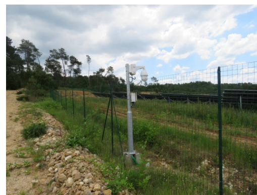
Installation de surveillance au nord du parc photovoltaïque
